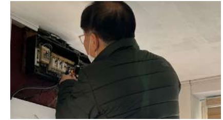
01.10. <뻬뻬보관소 전기 차단기 수선> 김연규, 김현주 정산 마무리 후 마을 방문. 온풍기가 작동 중 계속 꺼지게 되어 건물주분께 도움 요청을 드렸는데 전기 차단기를 수선해 주심. 바닥을 예쁜 페인트로 칠했으면 좋았을텐데 라고 조언해주심.
