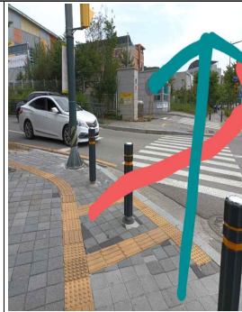
잘못 설치된 점자 블록 ①,③
