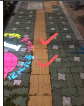
잘못 설치된 점자 블록 ①
